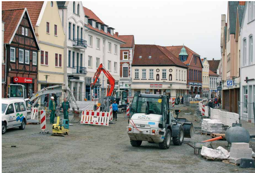
Schlechte Planung führt in Verden zu höheren Baukosten am Rathausvorplatz.
