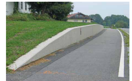
Die Stützmauer eines Radwegs bei Schonstett hat ein bewegtes Hin und Her.
