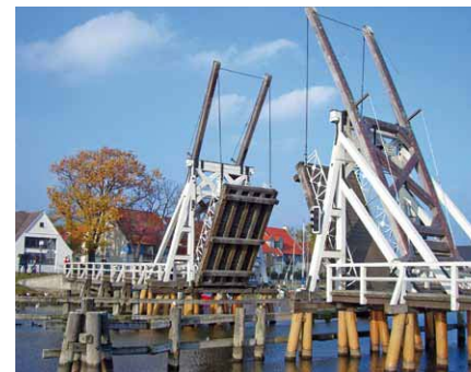
Wo rohe Kräfte sinnlos walten ... Die Klappbrücke über die Ryck leidet darunter.
