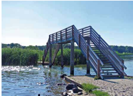
An dieser Brücke wurde fälschlicherweise das Gelände abgesägt.
